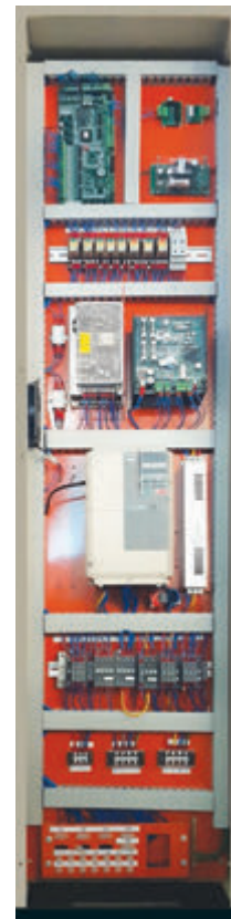
Tủ chính/ Main Cabinet
